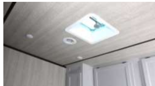
Bedroom Overhead Vent Fan
