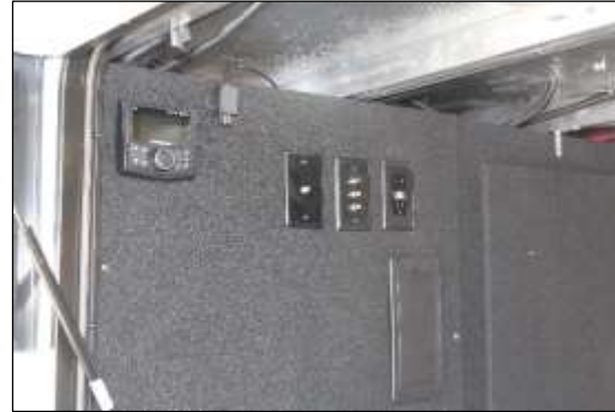
Exterior TV Hookups
