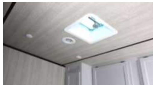
Bedroom Overhead Vent Fan
