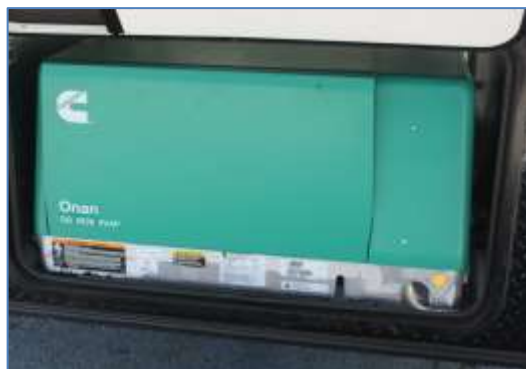
Onan 5.5KW Generator
