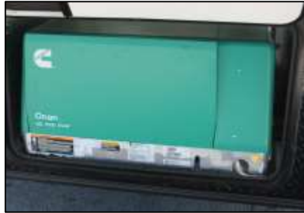
Onan 5.5KW Generator
