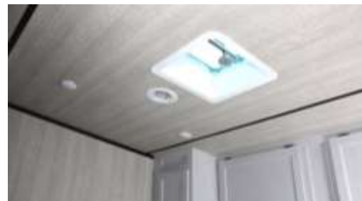
Bedroom Overhead Vent Fan
