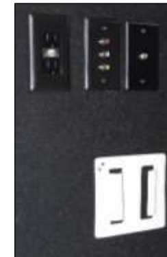
Exterior TV Hookups
